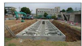
雨水貯留浸透施設(熊本市東区東町)
