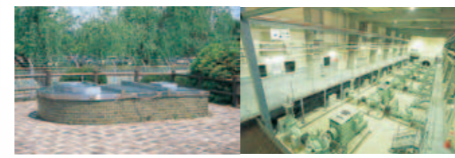
取水井外観 取水井内部 配水ポンプ ポンプで圧力をかけて、水をみなさんのところ(家庭)へお届けしています。
