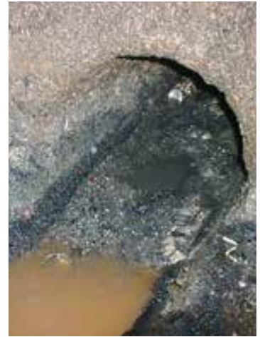
(腐食したマンホール内部)
