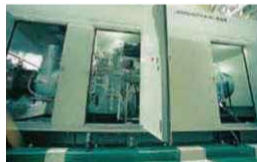
非常用発電設備の整備
