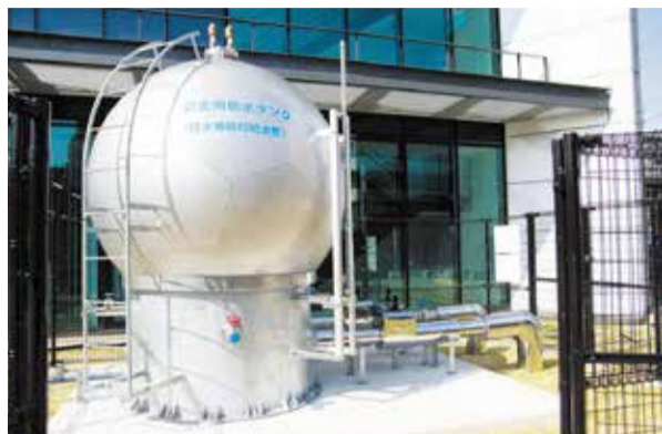
熊本市上下水道局前に設置された災害用給水タンク
