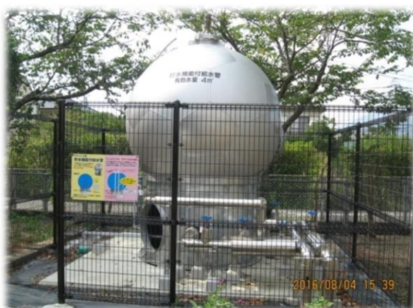
災害用給水タンク （貯水機能付給水管）
