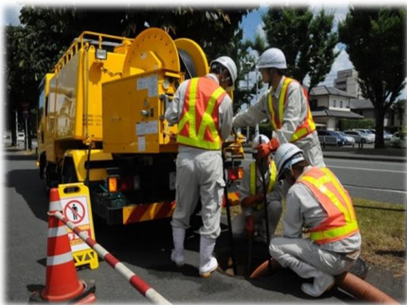
下水道管路の維持管理
