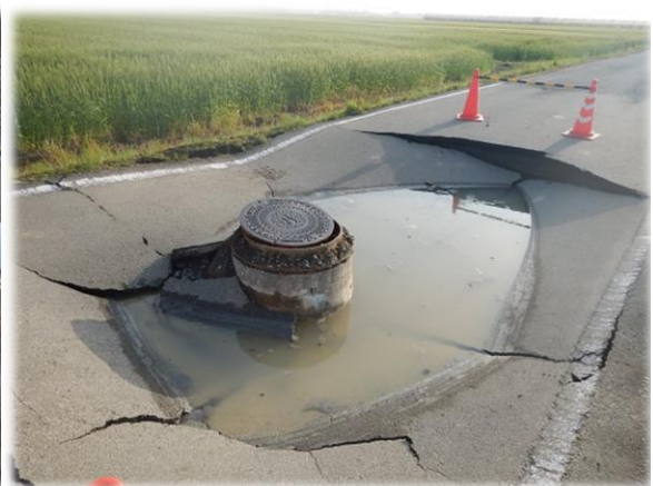
熊本地震による下水道（管路）被災状況
