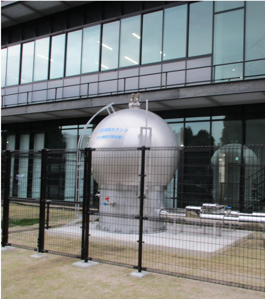
災害用給水タンク（貯水機能付給水管）
