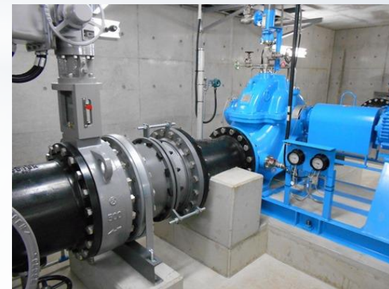
小水力発電設備
