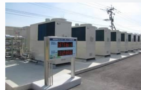
消化ガス発電設備
