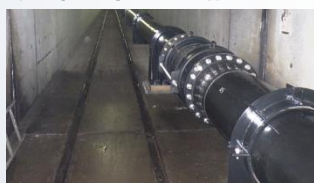
耐震化済の水道基幹管路
