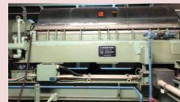
汚泥脱水機（中部浄化センター） R 3 更新予定
