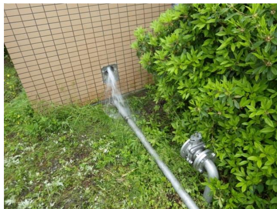
熊本地震による送水管の被害
