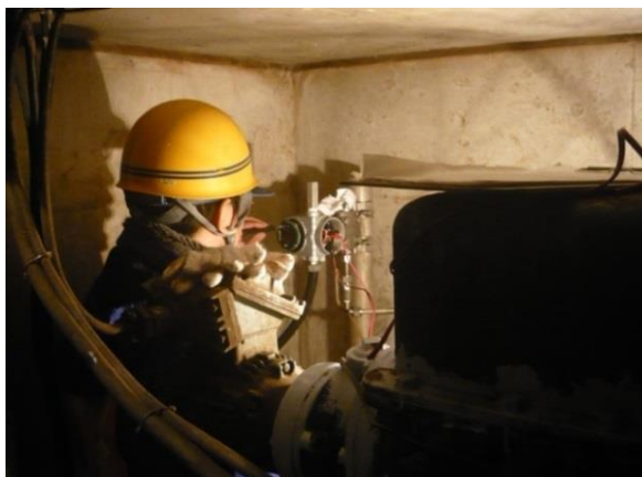
圧力計の点検
