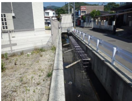
分水施設（井芹川第9排水区）
