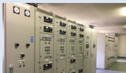
ポンプ操作盤（庄口水源地） R 2 更新予定
