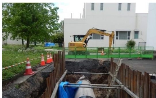
熊本地震の被害を受けた下水道施設の復旧
