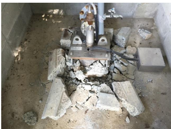
熊本地震による井戸ポンプの被害
