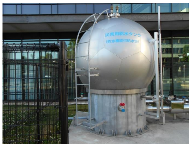
上下水道局内に設置した貯水機能付給水管
