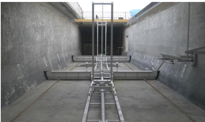
更新した汚泥掻き寄せ機
