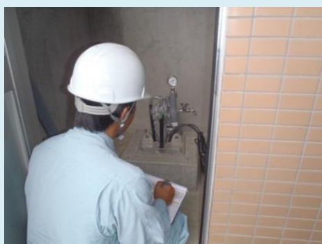
井戸ポンプの点検
