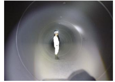
写真 4-2-1 雨水バイパス管
