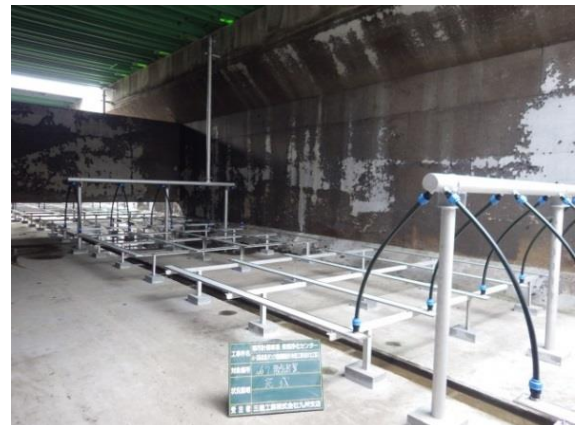
写真 4-3-10 超微細式散気装置*（東部浄化センターA系統）
