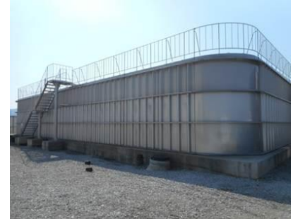
写真 4-3-4 災害対策用貯水施設 (南部送水場)
