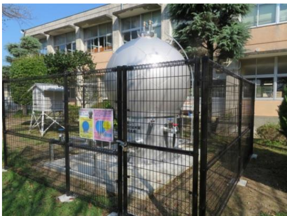
写真 4-3-6 貯水機能付給水管
