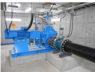
写真 4-3-11 小水力発電 （戸島送水場）
