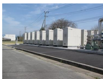
写真 4-3-12 消化ガス発電 （東部浄化センター）
