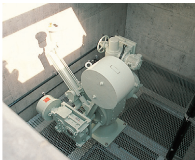
緊急遮断弁 震度6弱以上で作動し配水池からの水の流失を防ぎます
