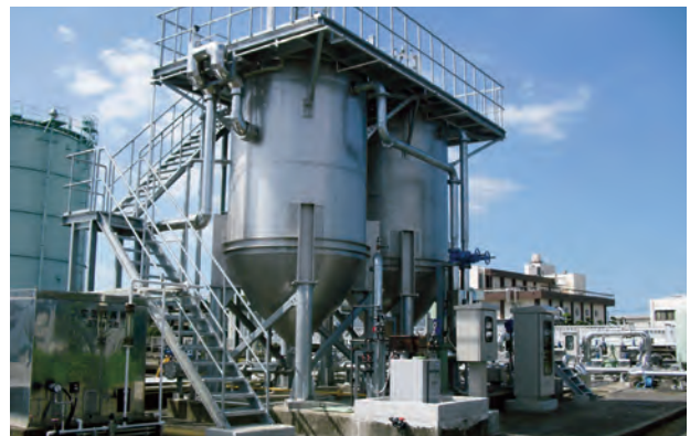
処理水を通過させ細かいごみを取り除き、緑地用水や機器の洗浄用水などに利用できるよう処理する施設です。
