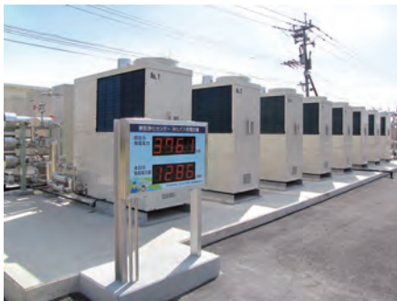
マイクロガスエンジン発電機
