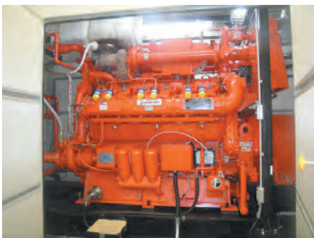
ガスエンジン発電機
