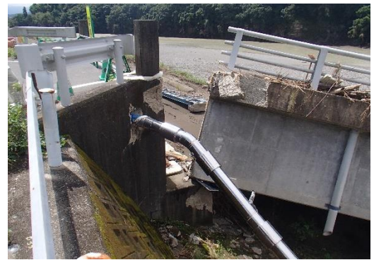
【球磨村水道施設の被害状況】
