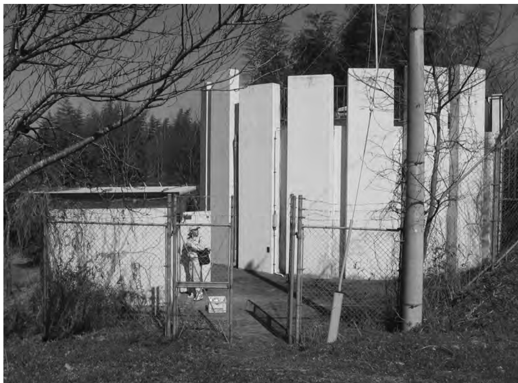
工業用水道配水池
