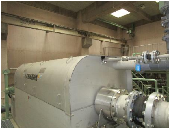
更新した機械濃縮機（南部浄化センター）
