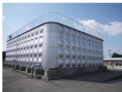
舞原配水場（城南）
