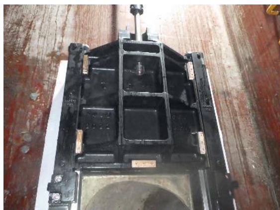
更新した流入ゲート(下水道施設)
