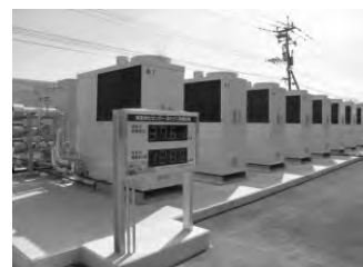
消化ガス発電設備 (上)中部浄化センター消化ガス発電機(エンジン) (下)東部浄化センター消化ガス発電設備(マイクロエンジン)
