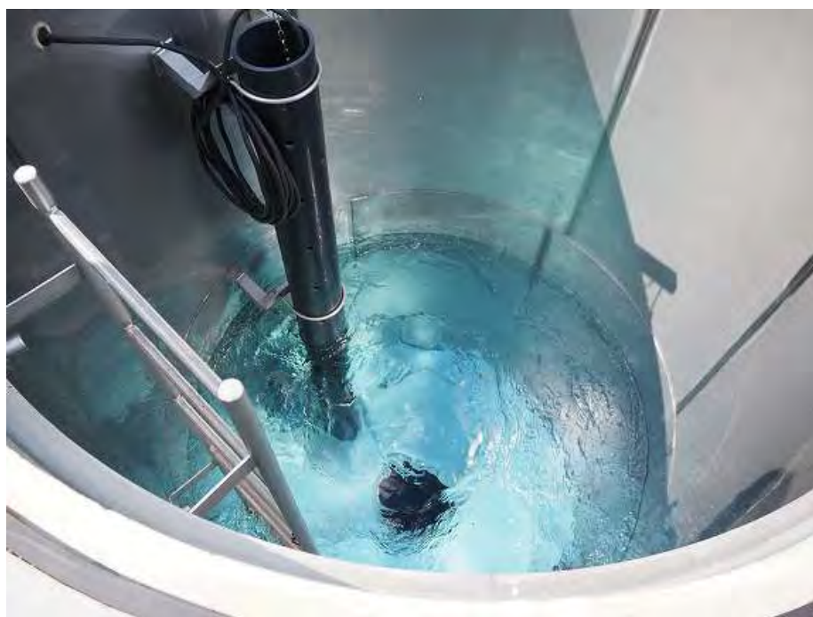
健軍水源地取水井内部
