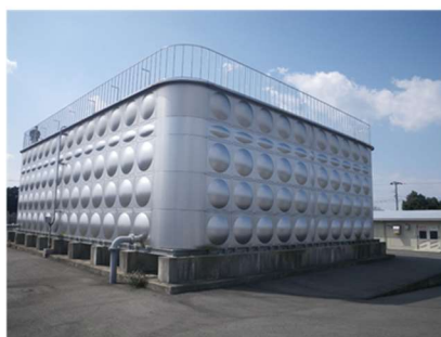
舞原配水場（城南）
