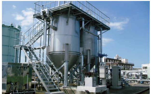
処理水を通過させ細かいごみを取り除き、緑地用水や機器の洗浄用水などに利用できるように処理する施設です。
