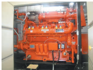
ガスエンジン (発電機)
