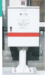
マンホールポンプ
