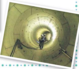
雨水貯留バイパス管
