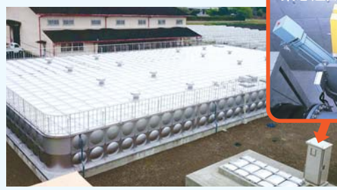
戸島送水場調整池。タンクはSUS(ステンレス製)で、容量は3000m 3 (1池あたり1500m 3 )
