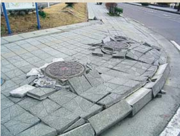
地盤が沈下し、マンホール管が突き出した状態に(白石市)
